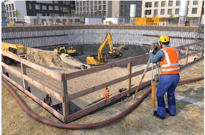
Abb. 22 Dreiteiliger Seitenschutz als Absturzsicherung
